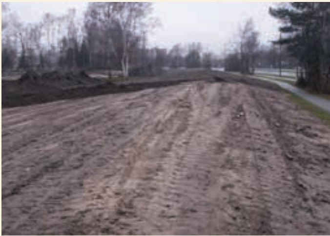
Passiert immer wieder: Von der beauftragten Fachfirma wurde humoser Oberboden aufgebracht. Er musste wieder entfernt werden (Foto: T. Konopka)
